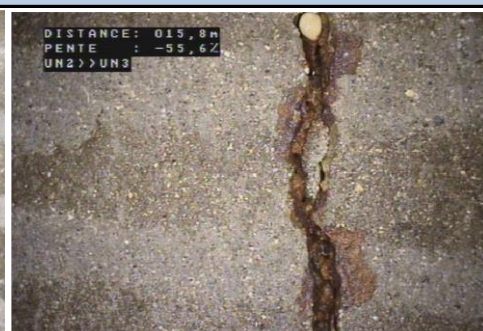
Fissure ouverte circulaire
