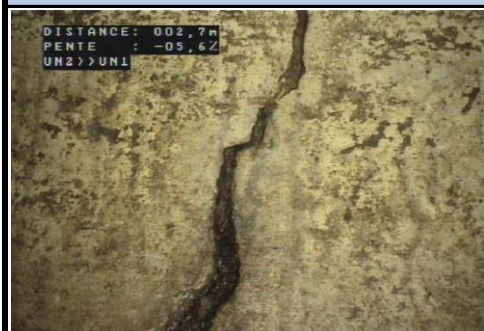
Fissure ouverte circconférentielle
