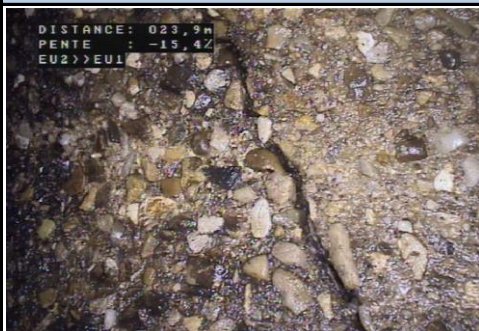
Fissure ouverte circumférentielle
