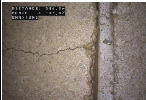
Fissure fermée longitudinale
