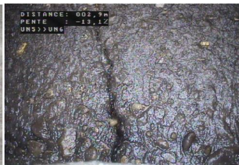
Fissure ouverte circumférentielle
