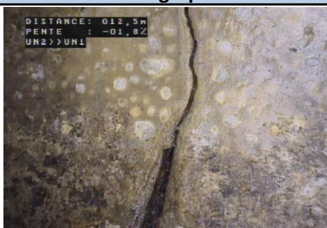
Fissure ouverte circconférentielle
