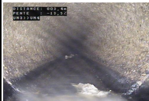
Dépôt dur ou compacté
