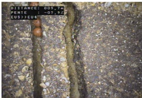
Fissure ouverte circumférentielle
