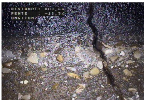
Fissure ouverte circumférentielle
