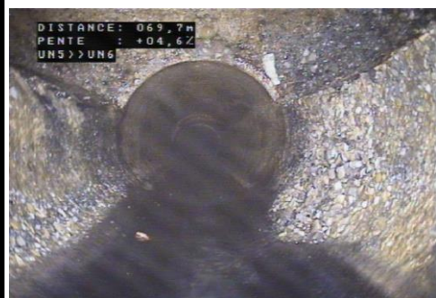
Dégradation de surface
