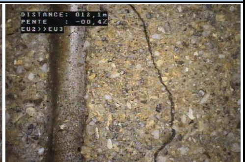
Fissure ouverte circumférentielle
