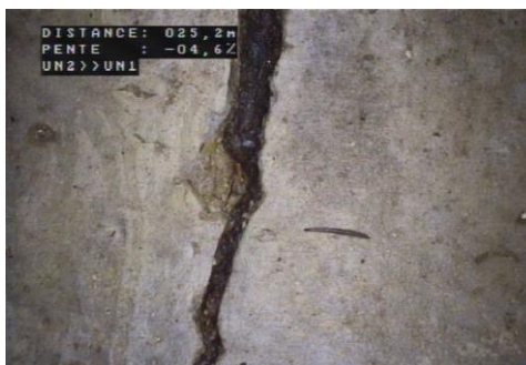
Fissure ouverte circconférentielle
