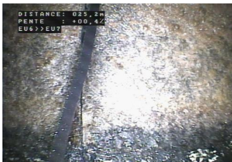
Joint d'étanchéité pénétrant et rompu
