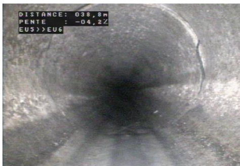
Joint d'étanchéité pénétrant mais non rompu
