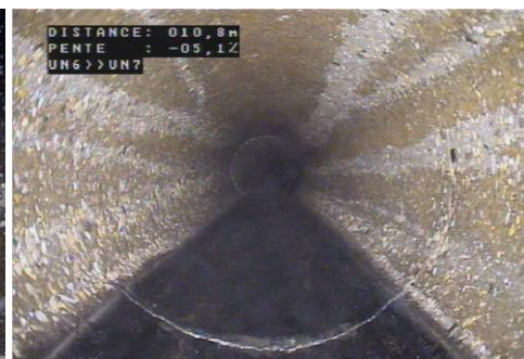
Fissure ouverte circumférentielle
