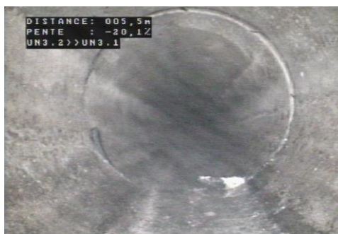
Joint d'étanchéité pénétrant et rompu
