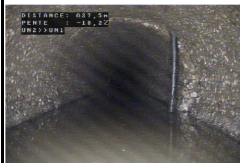
Joint d'étanchéité pénétrant mais non rompu
