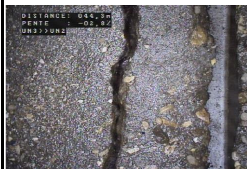
Fissure ouverte circumférentielle
