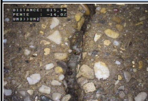
Fissure ouverte circumférentielle
