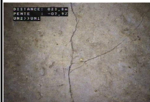
Fissure ouverte circconférentielle
