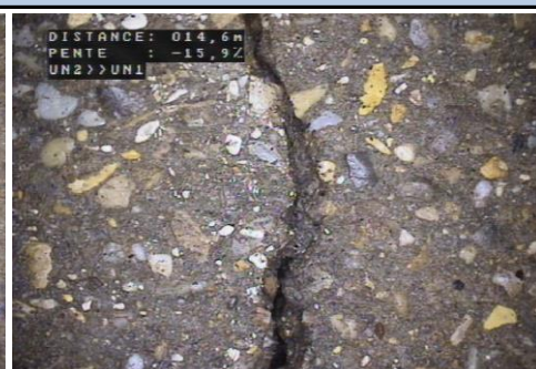
Fissure ouverte circumférentielle
