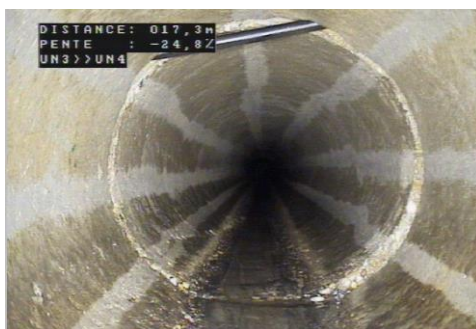
Joint d'étanchéité pénétrant mais non rompu
