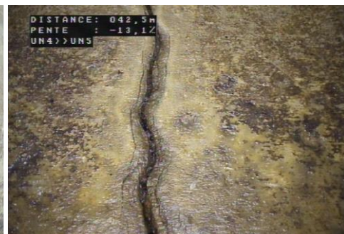
Fissure ouverte circconférentielle
