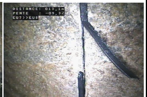
Joint d'étanchéité pénétrant et rompu
