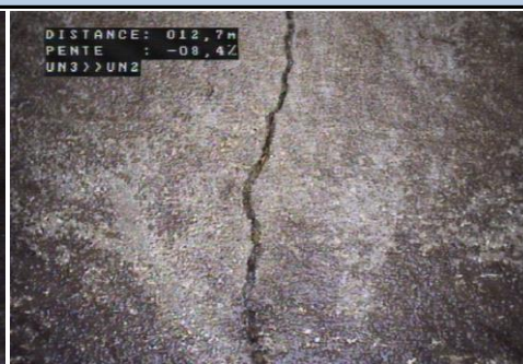
Fissure fermée circumférentielle
