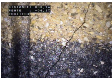
Fissure ouverte circumférentielle
