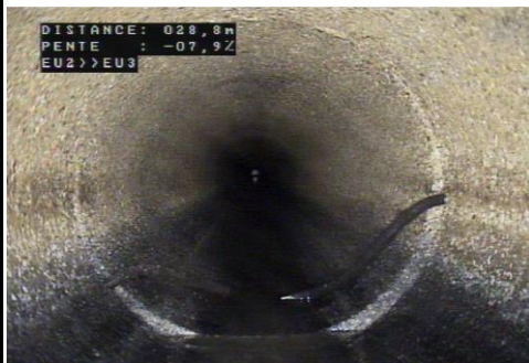
Joint d'étanchéité pénétrant et rompu
