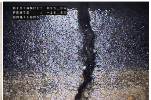
Fissure ouverte circumférentielle
