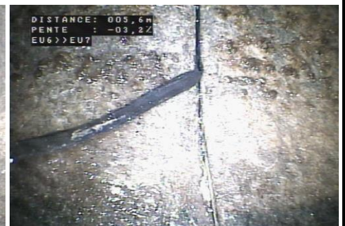
Joint d'étanchéité pénétrant et rompu
