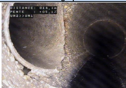
Sol visible par le défaut
