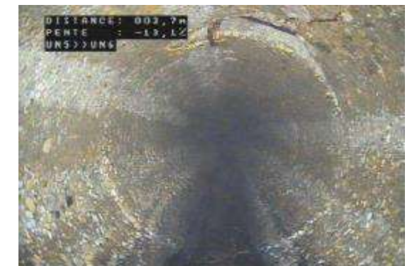
Rue Olivier de Serres (effondrement en voute)
