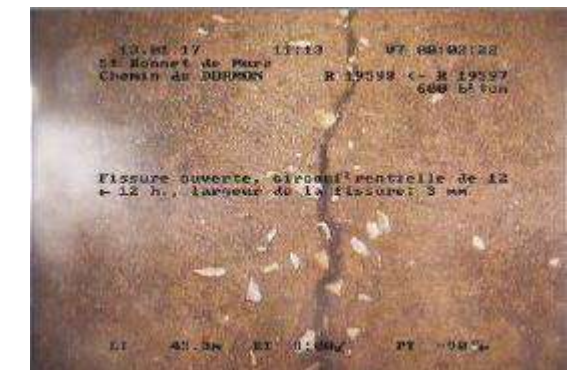
Route de Dormon (fissure sur conduite en béton)
