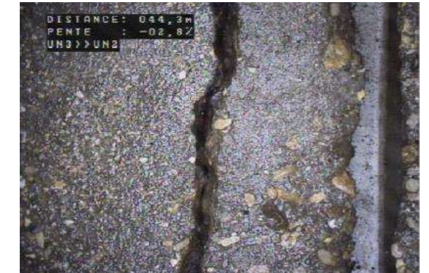
Rue Jean-Henri Fabre (fissure)
